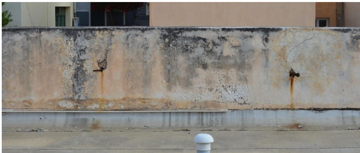
Εικ.83 Απώλεια κονιαμάτων-ρωγμές-αποχρωματισμοί- αποσάθρωση- βιολογική προσβολή
