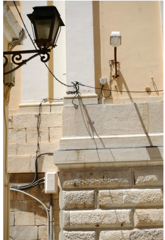
Εικ. 183 Ηλεκτρολογικές εγκαταστάσεις στην ανατολική όψη
