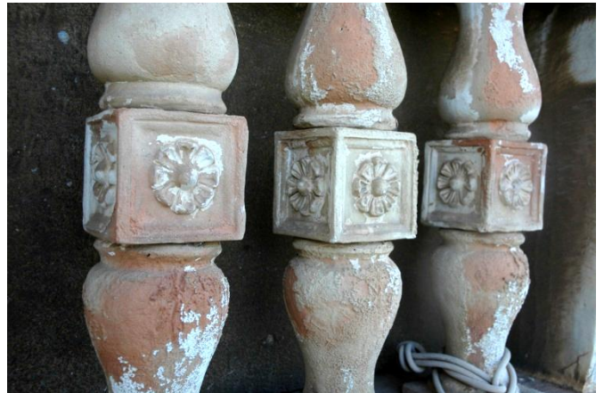
Εικ. 210 Αλλοίωση ανάγλυφου και χρωματικού στρώματος σε μπαλούστρα
