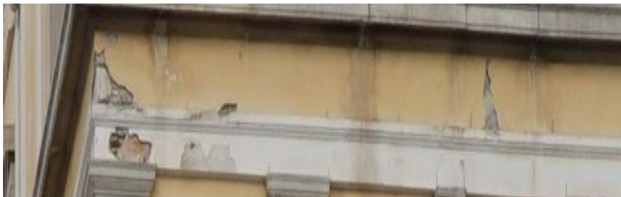
Εικ.80: Απώλειες επιχρισμάτων, αποκολλήσεις, λεκέδες υγρασίας
