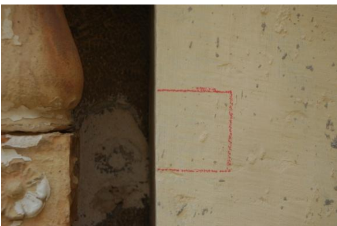
Εικ. 191 Δοκίμιο ΔΛ1 πριν την εφαρμογή υλικών
