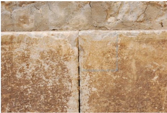
Εικ. 189 Δοκίμιο ΔΛ5 πριν την εφαρμογή υλικών
