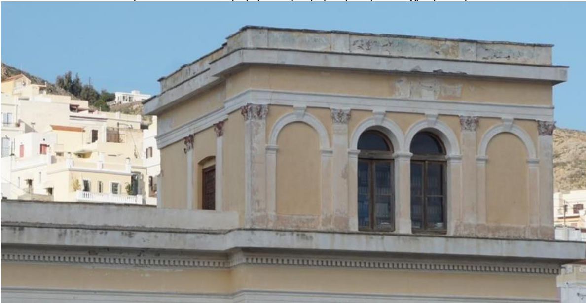
Εικ.87: Απώλεια κονιαμάτων- αποκόλληση- βιολογική προσβολή – αποχρωματισμοί-λεκέδες υγρασίας
