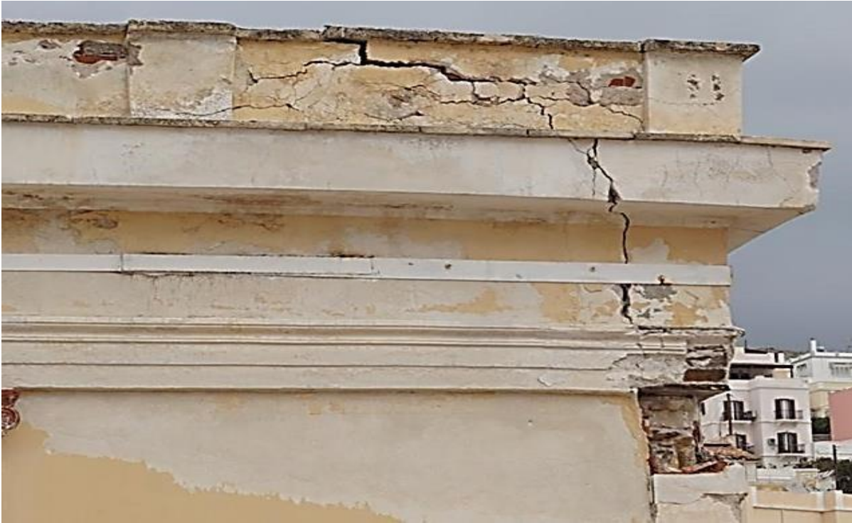
Εικ. 92: Αποκολλήσεις -λεκέδες υγρασίας- απώλεια επιχρισμάτων- αποδιοργάνωση δομικών στοιχείων- Νεότερα επιχρίσματα
