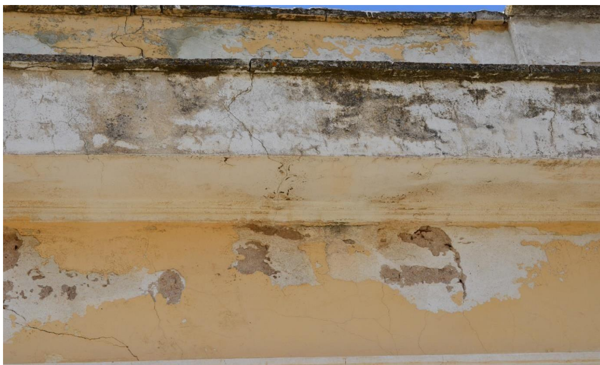
Εικ.82 Απώλεια κονιαμάτων-ρωγμές-αποχρωματισμοί- αποσάθρωση- βιολογική προσβολή
