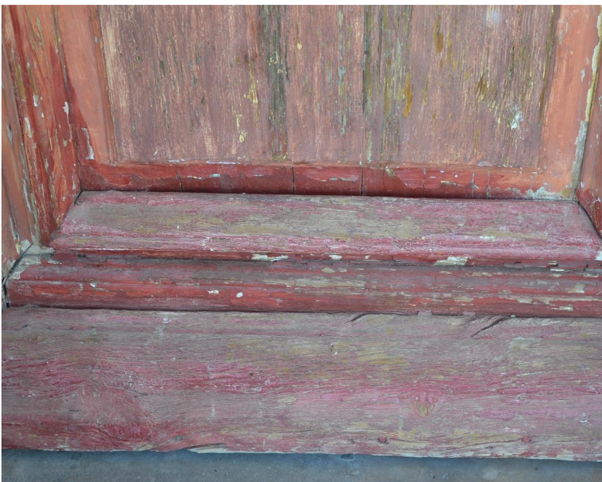
Εικ. 63: Επιχρωματισμός νεότερα στρώματα βαφής στην είσοδο Νότιας όψης
