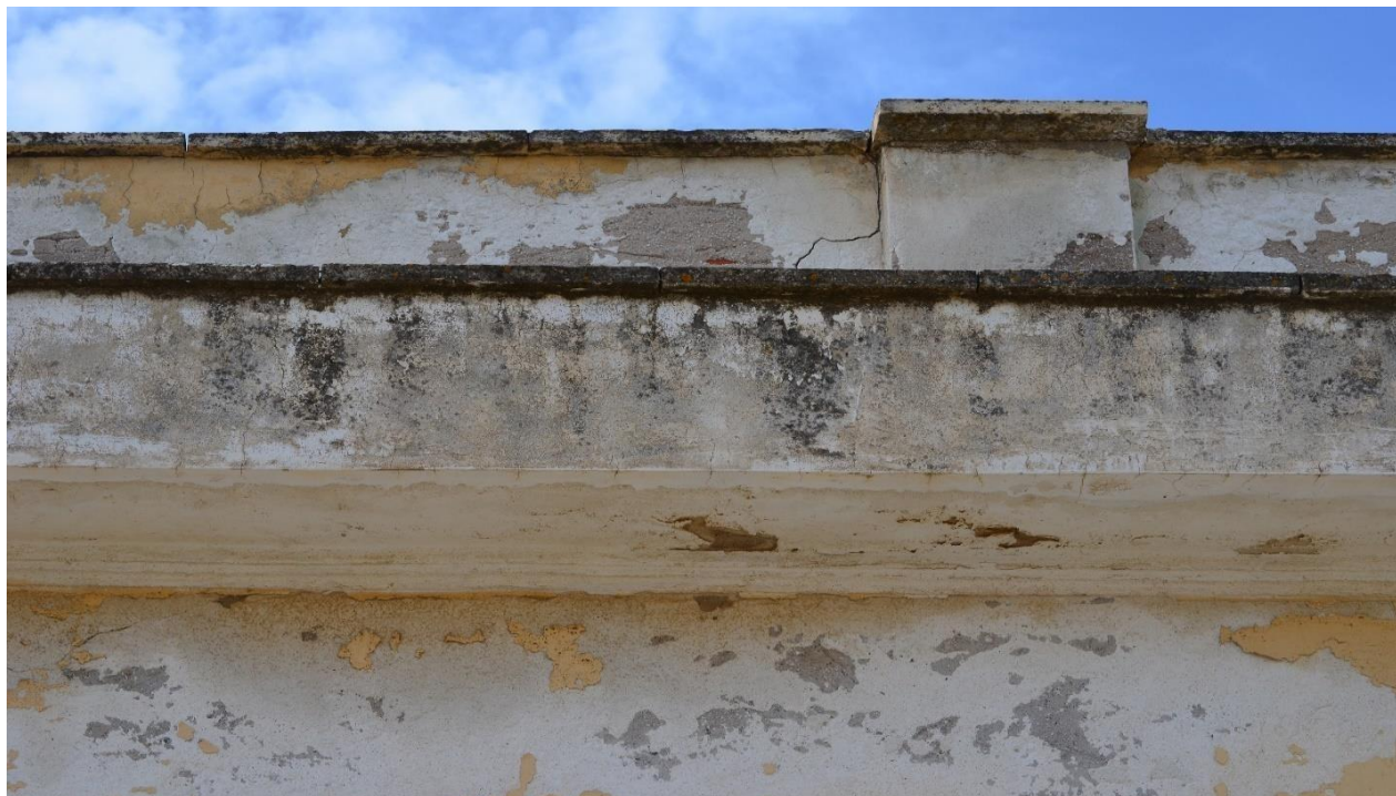
Εικ.78: Απώλειες επιχρισμάτων, αποκολλήσεις, λεκέδες υγρασίας
