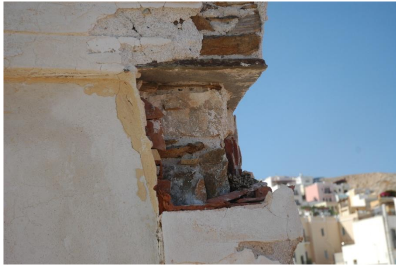
Εικ. 206 Απώλεια γωνιακού επίκρανου του τρίτου ορόφου των πύργων
