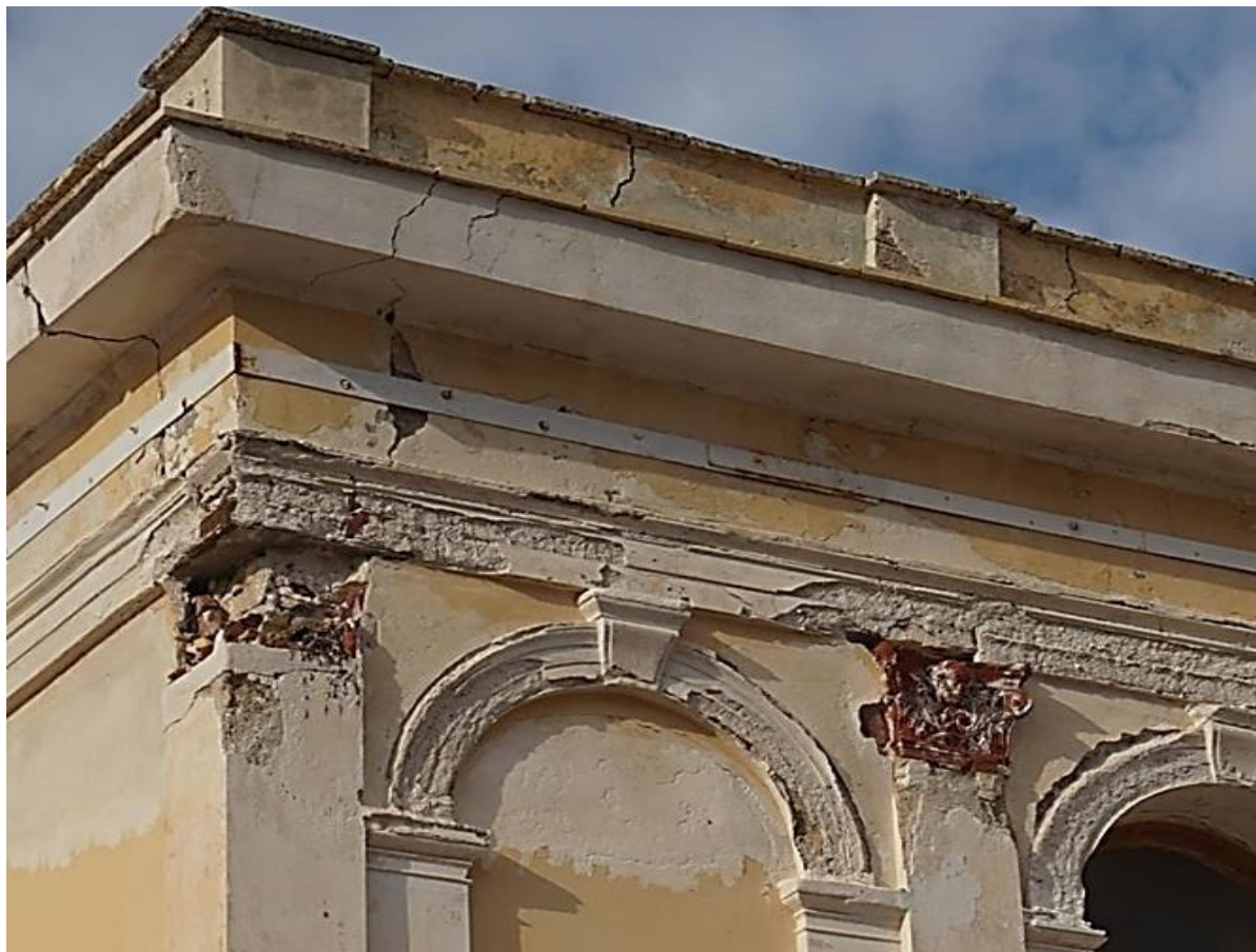
Εικ.89: Απόλεια κονιαμάτων- αποκόλληση- ρωγμές- αποχρωματισμοί-λεκέδες υγρασίας- νεότερα στοκαρίσματα
