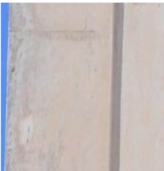
Εικ.95,Εικ.96 Ίχνη από μίμηση ορθομαρμάρωσης
