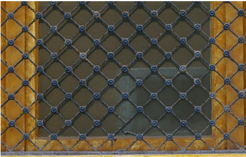
Εικ. 139 Παραμόρφωση, αποκόλληση μεταλλικών τμημάτων στη Θ3
