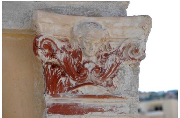
Εικ. 214 Ρωγματώσεις, υπολείμματα κονιαμάτων και μερική απόλεια χρωματικού στρώματος
