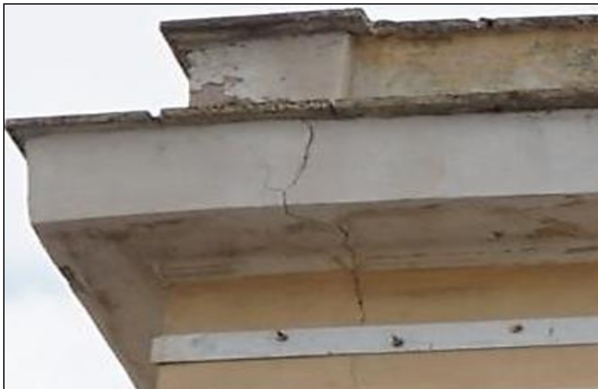
Εικ. 90: Ρωγμές-λεκέδες υγρασίας- απώλεια επιχρισμάτων
