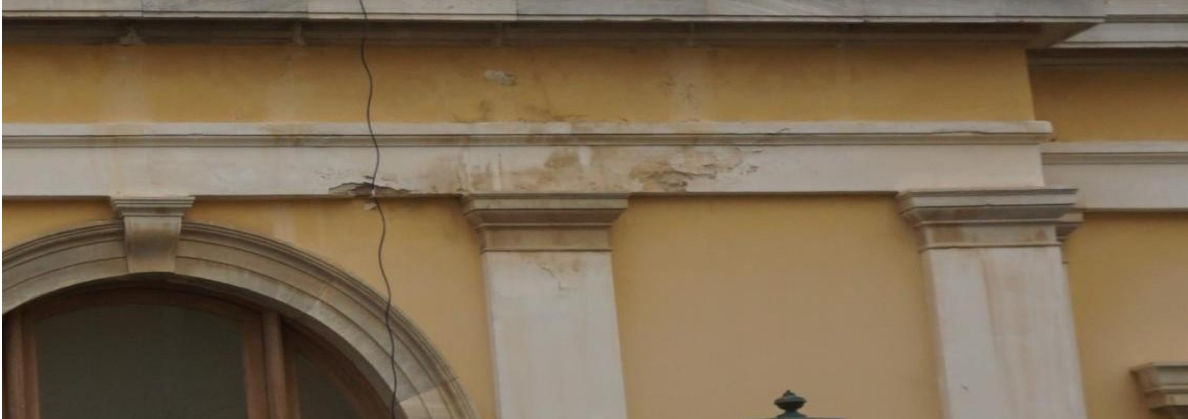
Εικ.88: Απώλεια κονιαμάτων- αποκόλληση- ρωγμές– αποχρωματισμοί-λεκέδες υγρασίας
