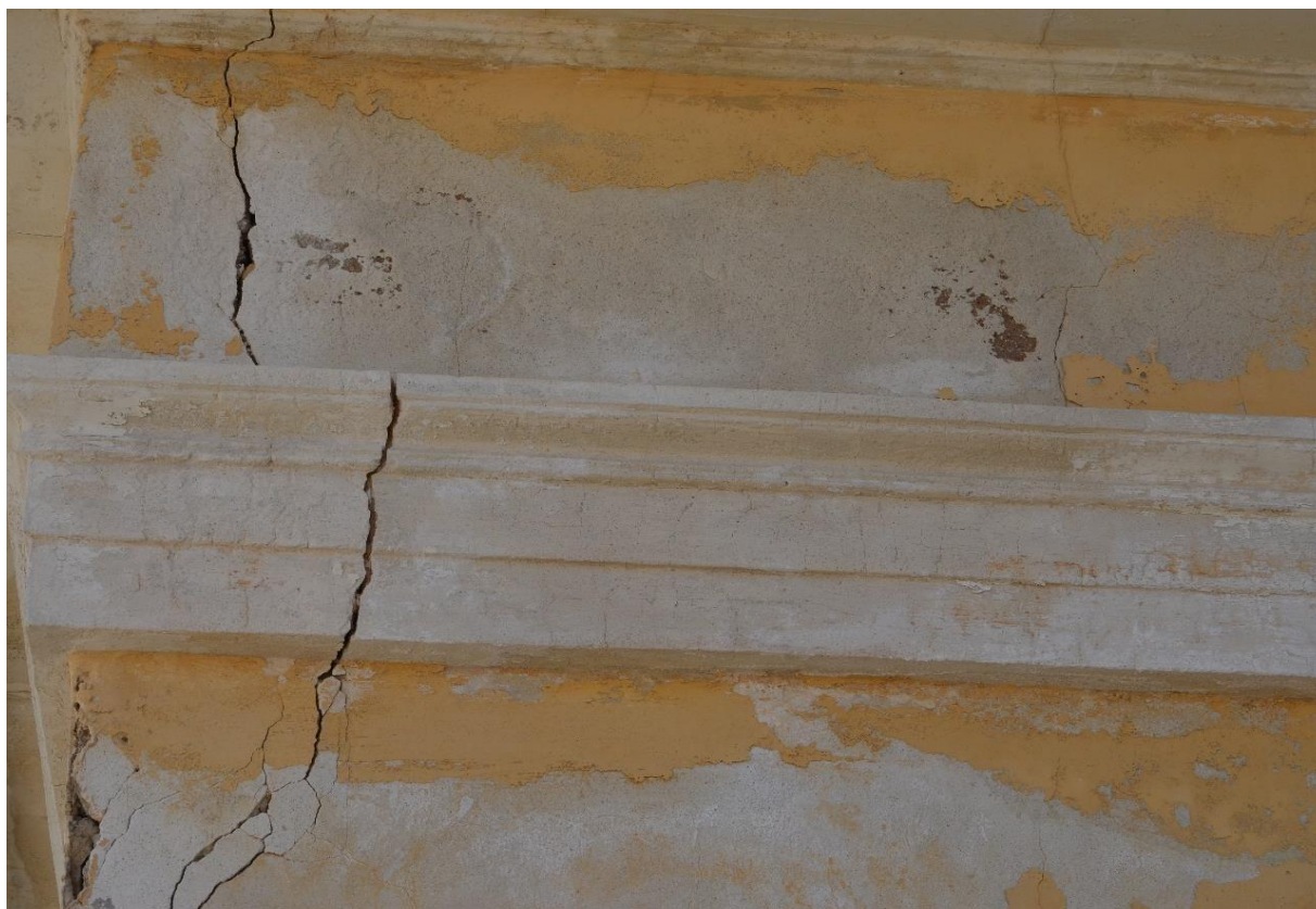
Εικ.81: Απώλεια κονιαμάτων-ρωγμές-αποχρωματισμοί- αποσάθρωση
