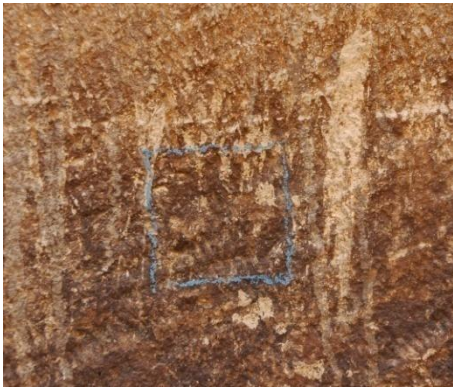
Εικ. 187 Δοκίμιο ΔΛ2 πριν την εφαρμογή υλικών
