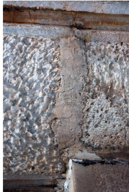
Εικ. 178 «Άστοχη» πλήρωση αρμού με κονιάμα
