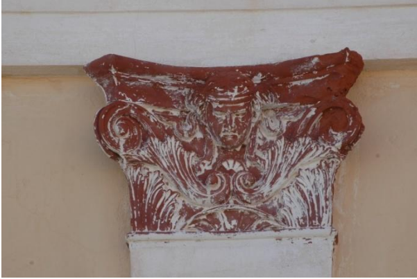
Εικ. 211 Απόλεια χρωματικού στρώματος
