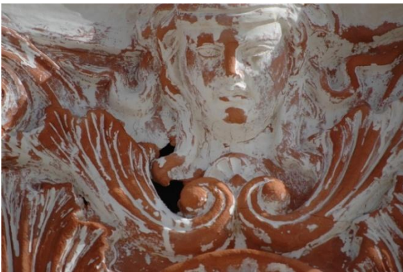
Εικ. 213 Οπές και απόλεια χρωματικού στρώματος
